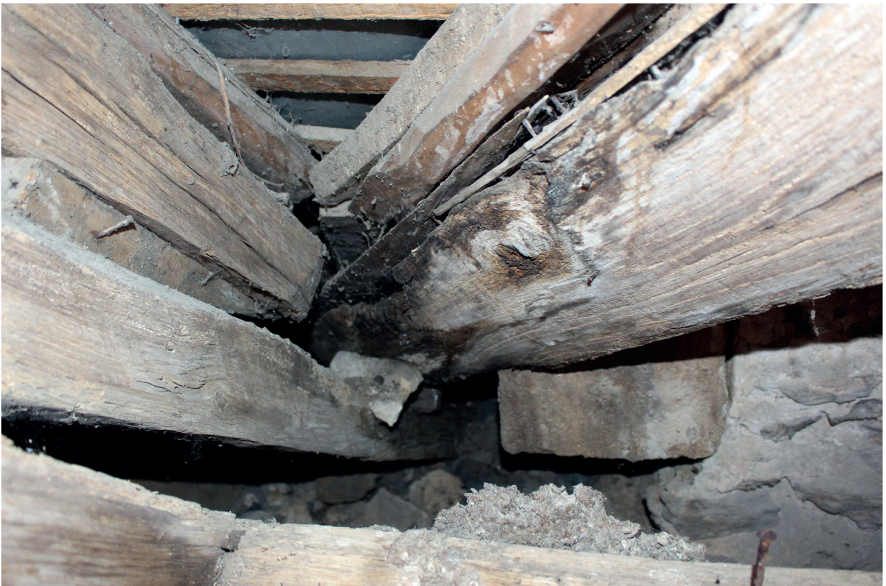
▲ Choeur. Ferme en état de pourrissement, à la jonction avec le bas-côté nord
