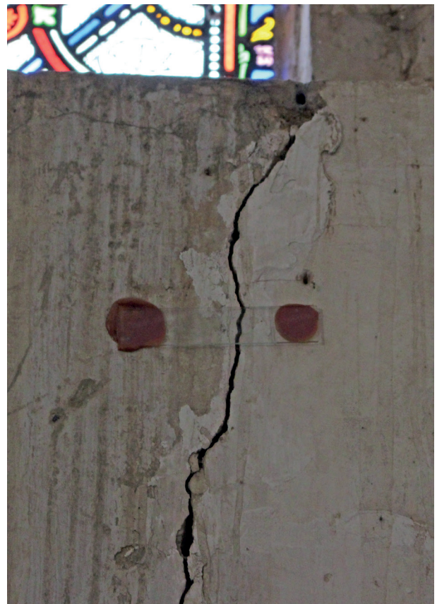
▲ Nef. Brèche verticale
