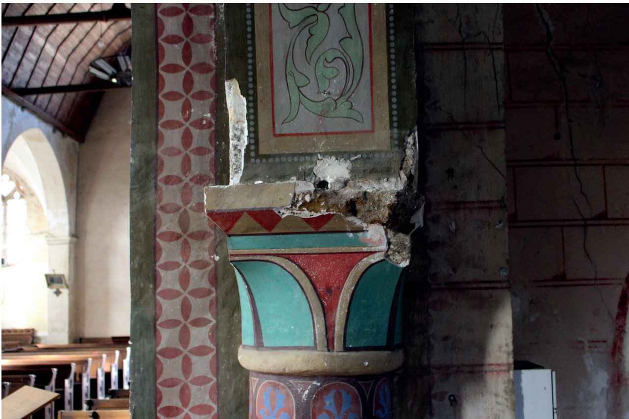
▲ Arc nord du chœur. Chapiteau fracturé
