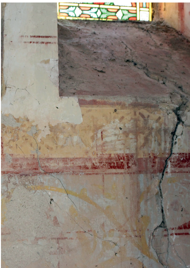
▲ Rez-de-chaussée du clocher. Brèche
