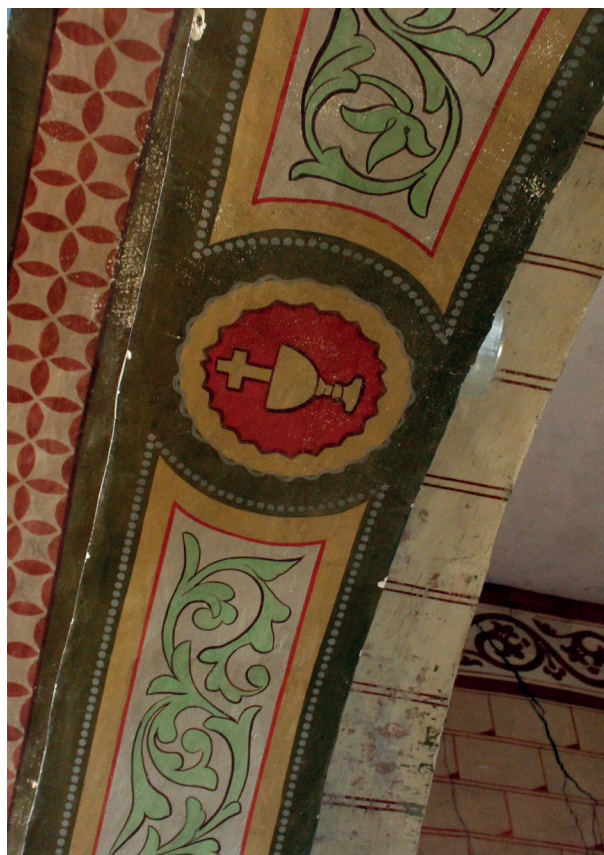
▲ Arc nord du chœur. Encrassement généralisé
