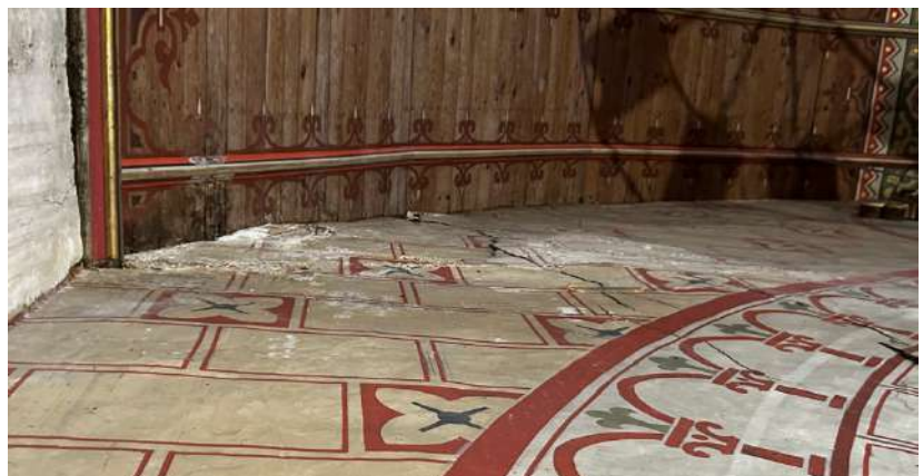
Soulèvements, décollements et pertes de matière liés à d'anciennes infiltrations en partie haute du mur diaphragme
