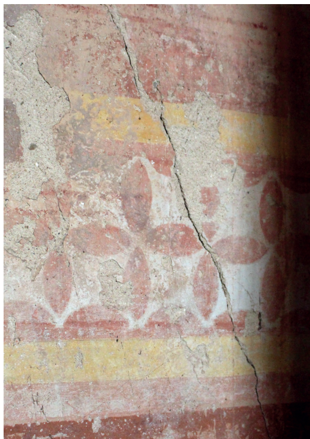
▲ Rez-de-chaussée du clocher. Fissure
