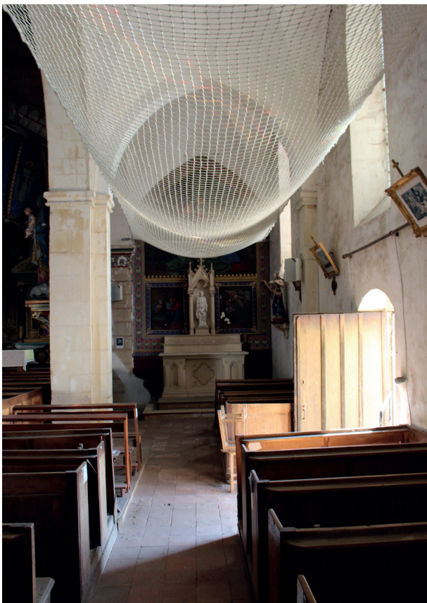
▲ Bas-côté sud. Filet de protection sous voûtes
