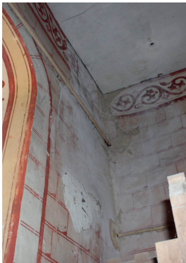
▲ Rez-de-chaussée du clocher. Décor altéré
