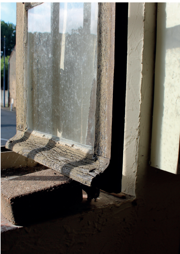
▲ Sacristie. Châssis en état de pourrissement
