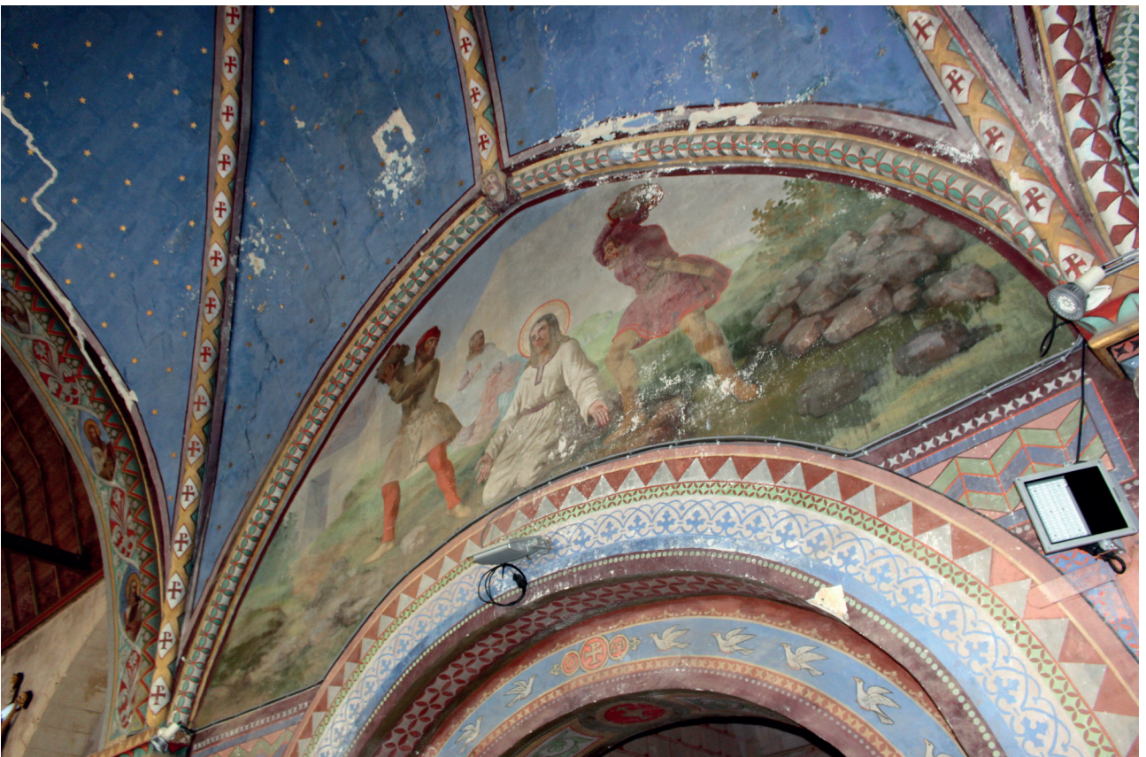
▲ Décors peints datés du XIX e siècle altéré, encrassé et lacunaires, suite à d'anciennes infiltrations notamment
