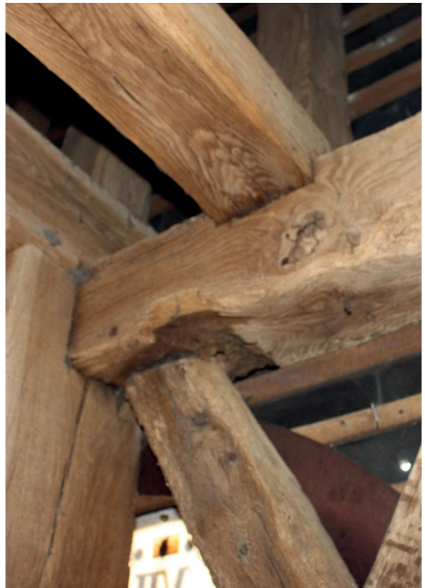
▲ Clocher. Défaut d'assemblage ponctuel
