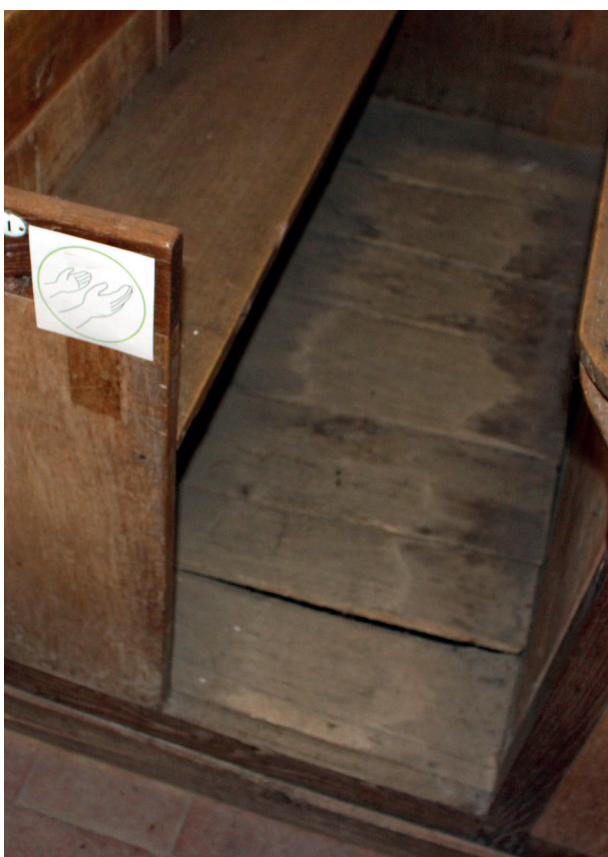
▲ Nef. Planchers menuisés localement altérés
