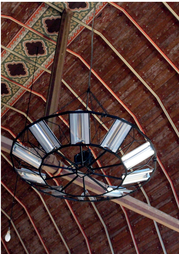
▲ Lustre chauffant assez inefficace
