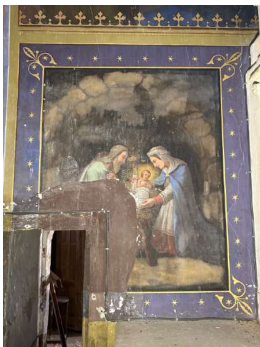
Bouchage au plâtre adapté mais grossièrement retouchée (bas-côté nord)
