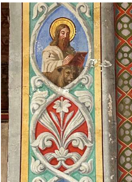
Ecaillages localisés au niveau de l'intrados
