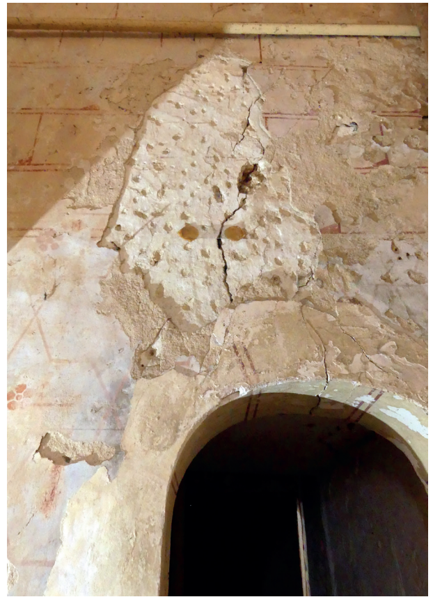
▲ Plaque d'enduit tombée laissant voir l'enduit ancien
