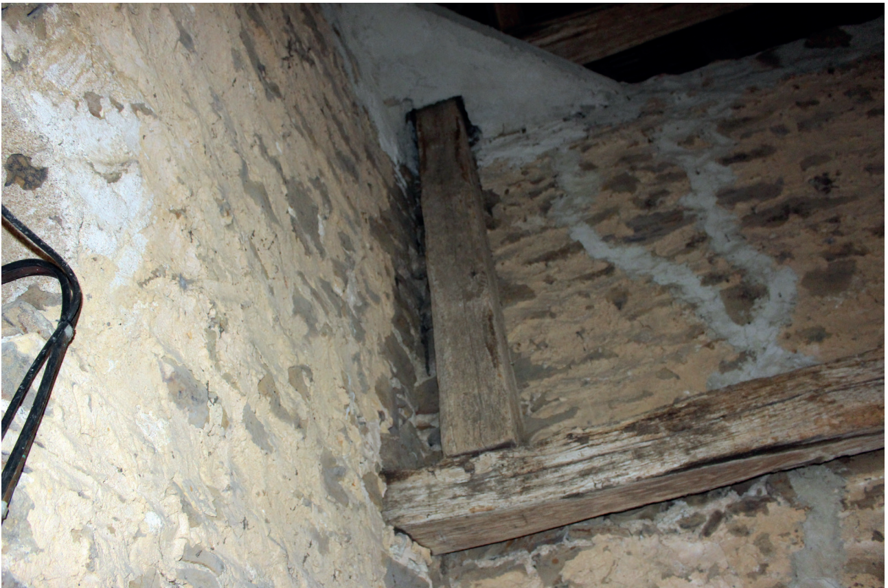
▲ Clocher. Anciennes brèches reprises au ciment
