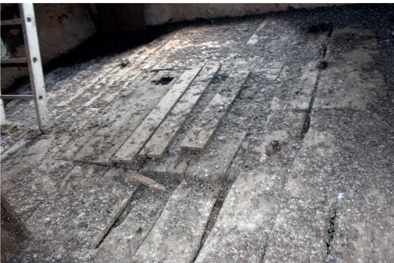
▲ Clocher. Plancher en mauvais état général
