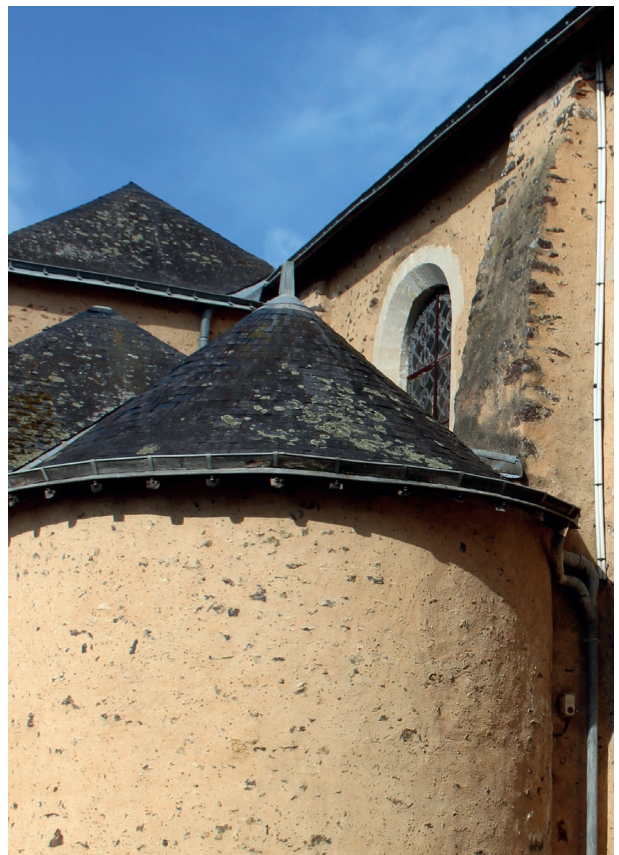
▲ Absidiole sud. État moyen de la couverture
