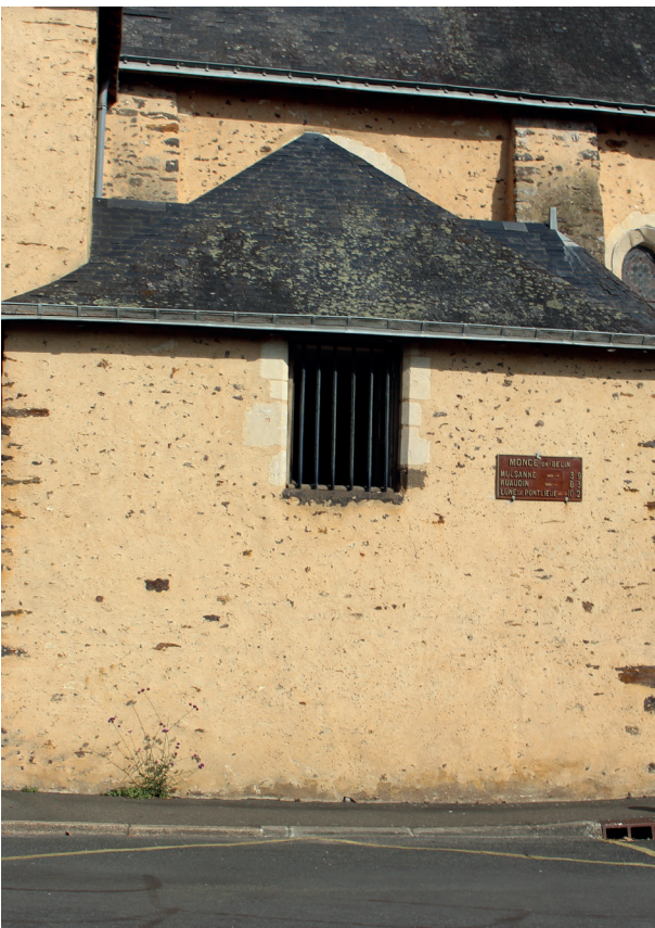
▲ Sacristie. Couverture en état moyen
