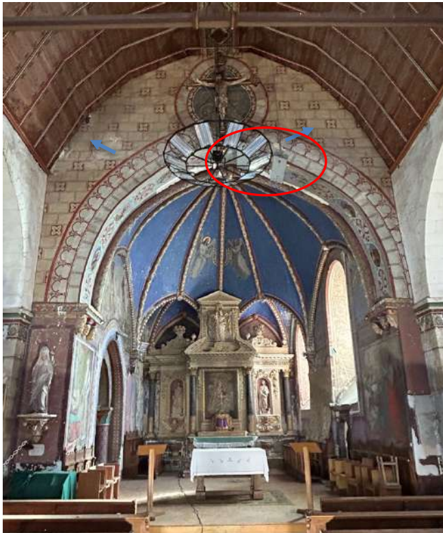
Fissures et affaissement de l'arc, aujourd'hui étayé
