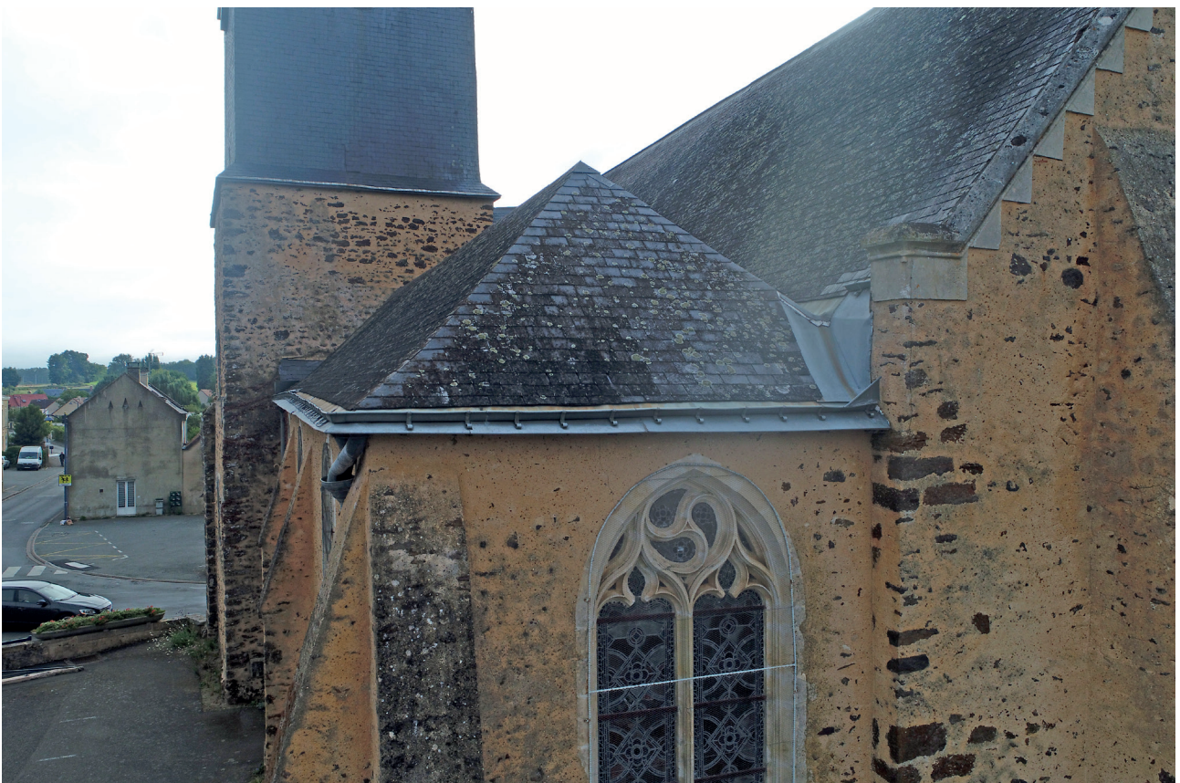
▲ Versant occidental du bas-côté nord. Versant en état moyen
