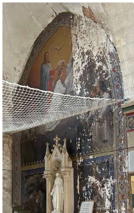
Bas-côté sud ayant subi une infiltration ayant entraînée une dégradation très avancée et très délimitée de la partie droite
