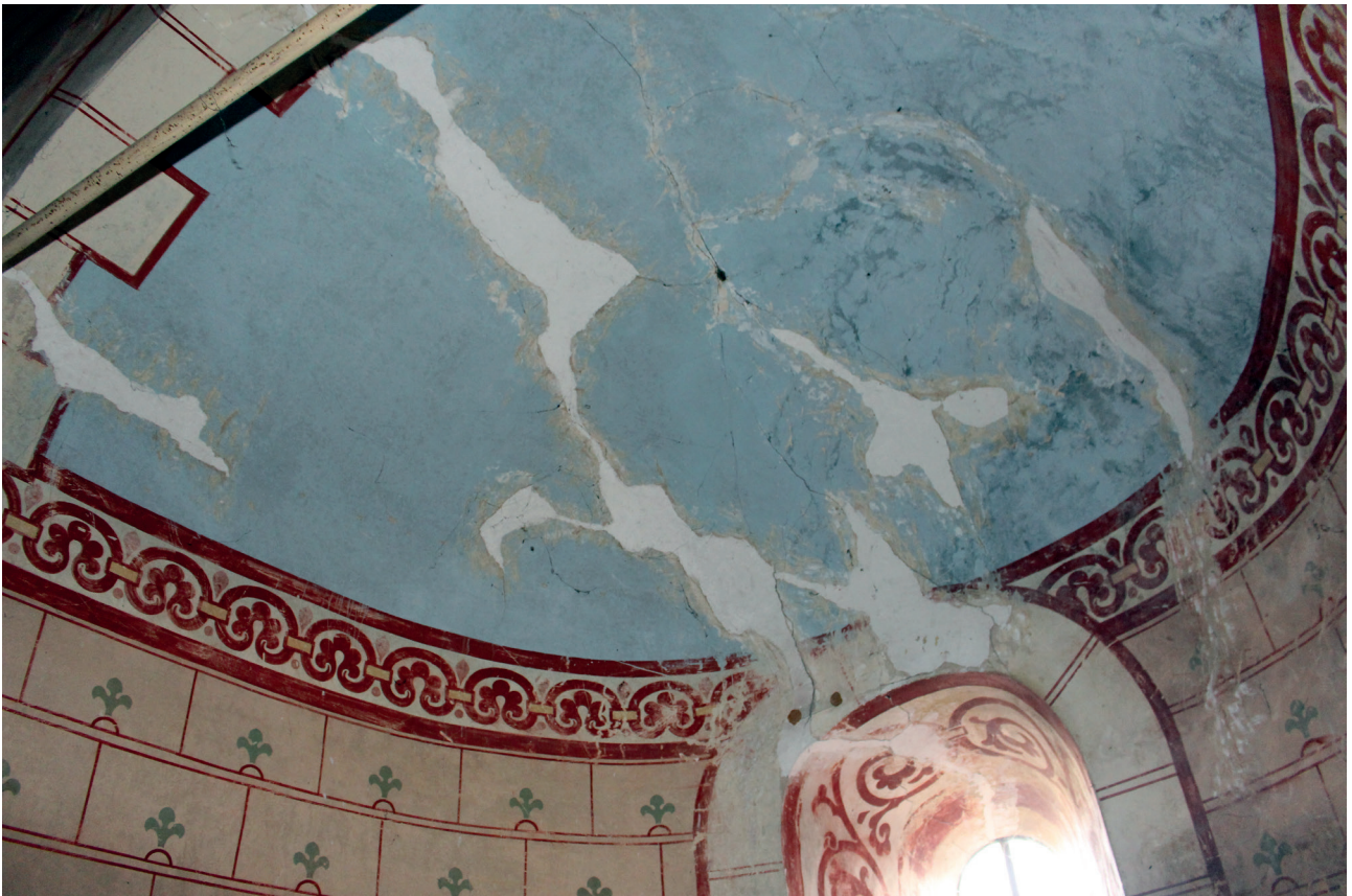
▲ Rez-de-chaussée du clocher. Voûte en cul-de-four fracturé
