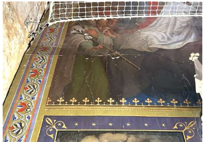
Nord : importants décollements déformés et instables des enduits de finition au plâtre
