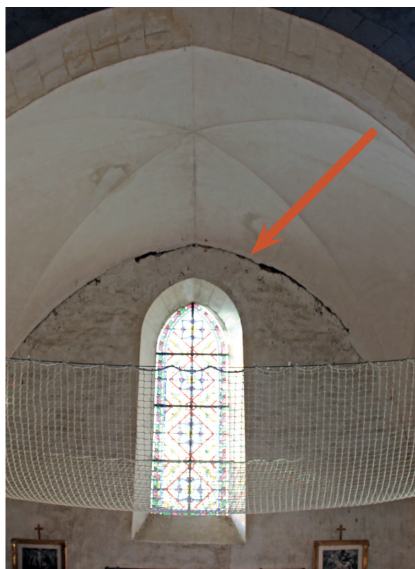
▲ Brèche à la jonction entre voûte en plâtre et élévation en pierre
