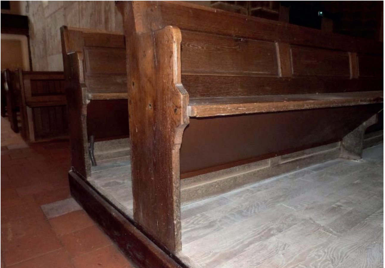
▲ Chauffage rayonnant bi-directionnel mis en place dans l'église de Auvers- le Hamon (72)
